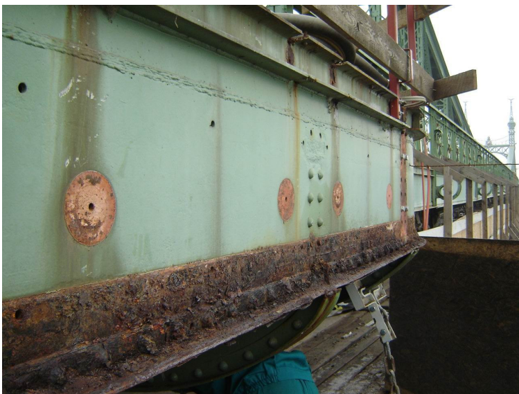
4. Teljesen elkorrodált szegélytartó
