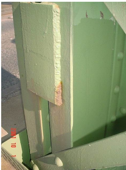
1. Repedt varratú főtartó heveder
