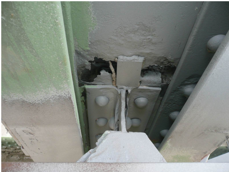
7. Súlyosan korrodált főtartó oszlop (1)
