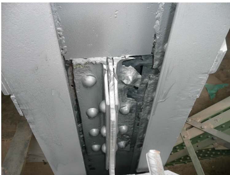
8. Súlyosan korrodált főtartó oszlop (2)
