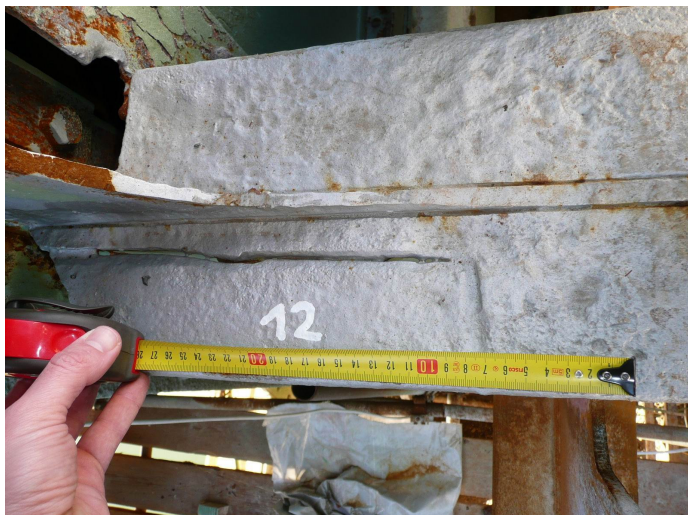
9. Bevágott, korrodált kt. felső öv
